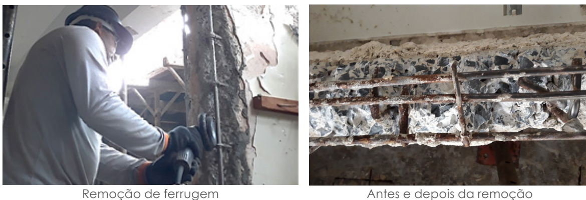
Figura 6 - Remoção da ferrugem e avaliação da barra
