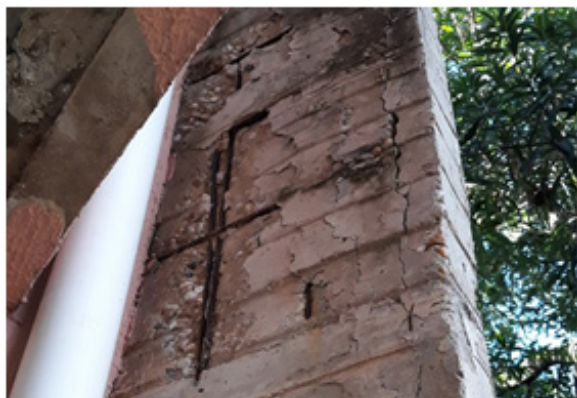
Desplacamento do concreto
