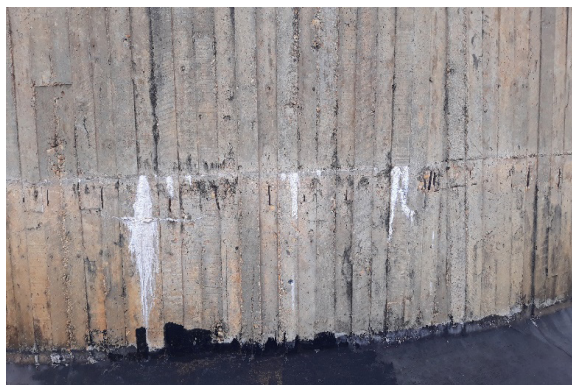
Armadura exposta e lixiviação
