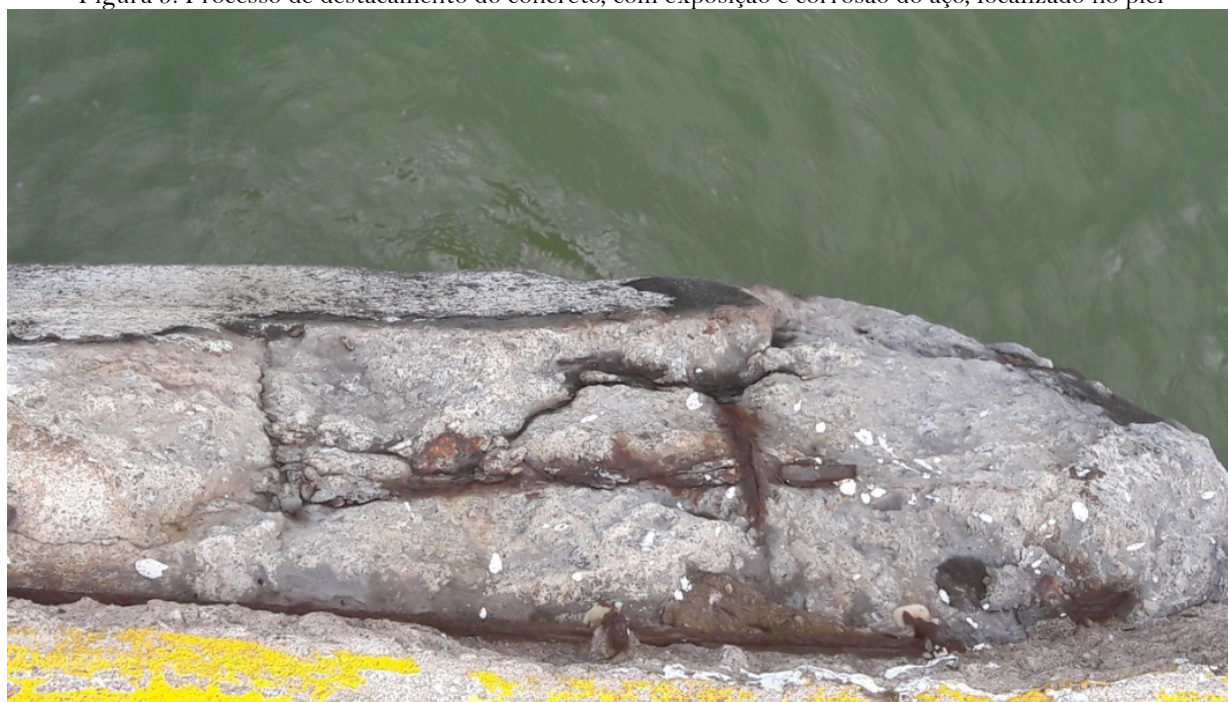
Figura 5: Processo de destacamento do concreto, com exposição e corrosão do aço, localizado no píer
