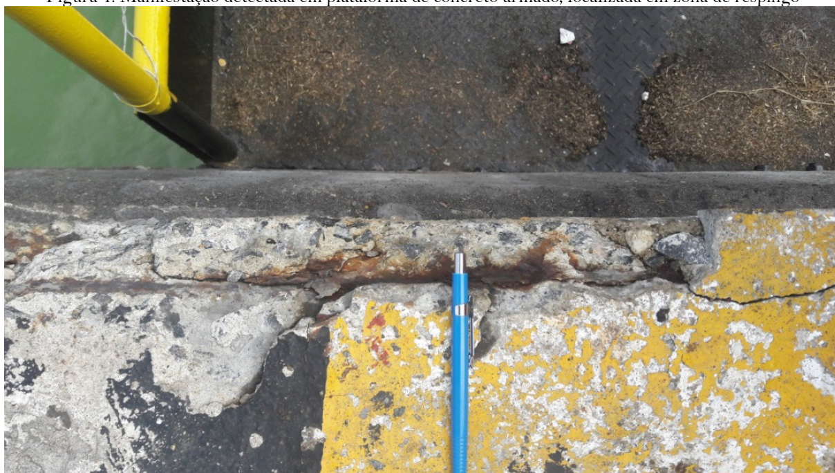
Figura 4: Manifestação detectada em plataforma de concreto armado, localizada em zona de respingo
