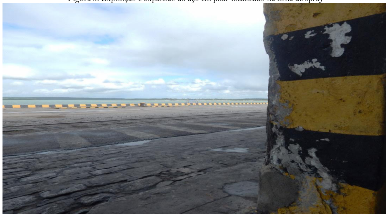
Figura 3: Exposição e expansão do aço em pilar localizado na zona de spray
