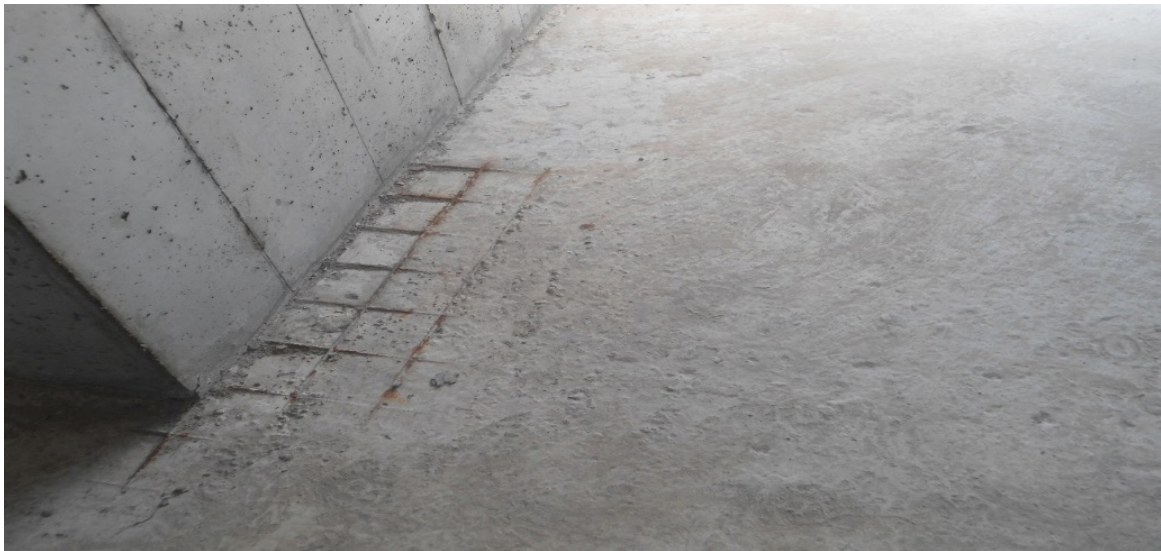
Figura 3: Armadura de laje exposta
