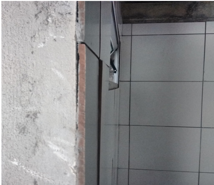
Figura 7: Revestimento cerâmico desaprumado
