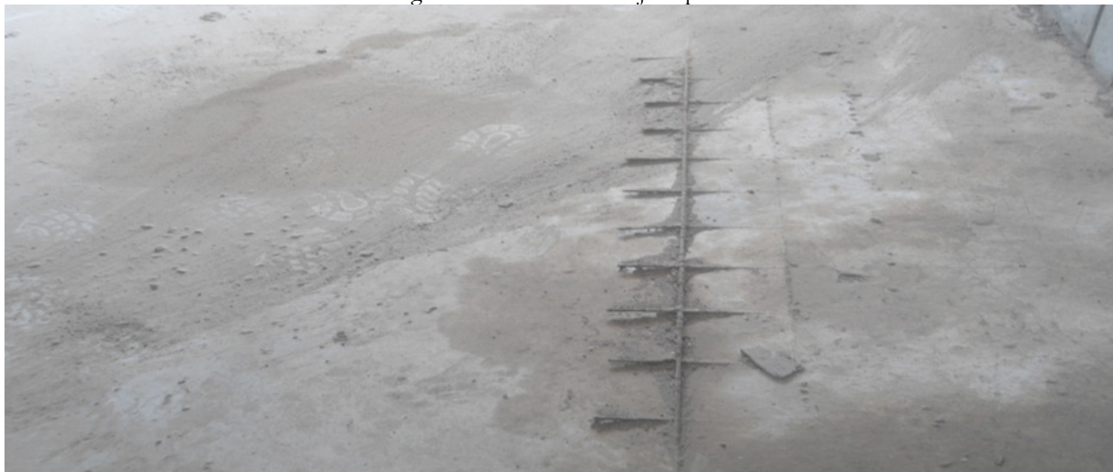
Figura 1: Armadura de laje exposta
