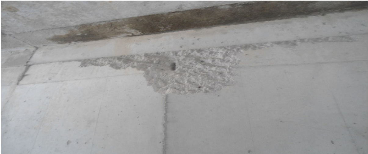
Figura 5: Falha no concreto devido à retirada incorreta das fôrmas
