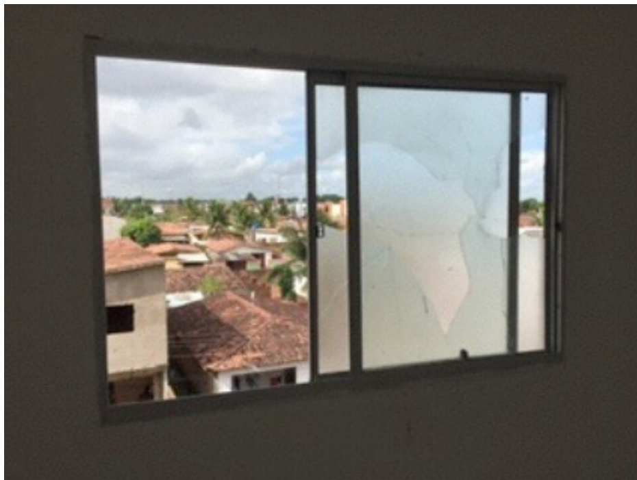
Figura 8: Quebra dos vidros de esquadria
