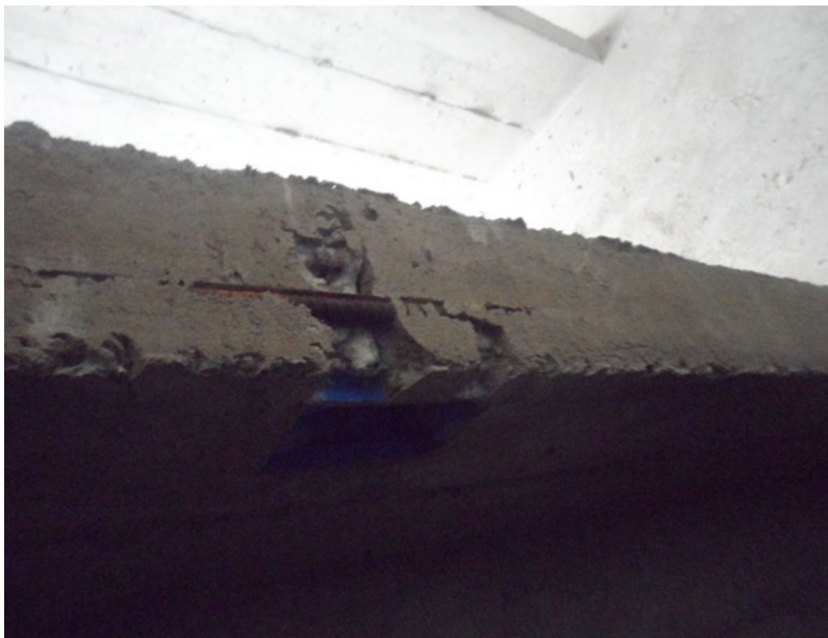
Figura 2: Armadura de parede de concreto exposta
