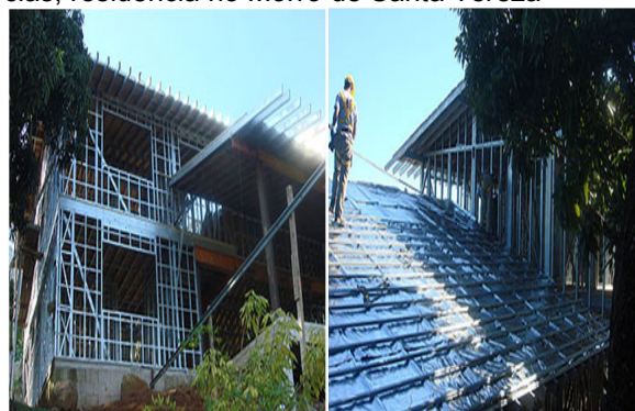
Figura 3 – A: Estrutura da residência no Morro de Santa Tereza; B: Fechamento com placas cimentícias, residência no Morro de Santa Tereza
